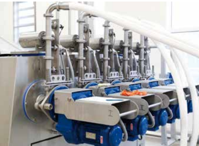
In de powerheater wordt het product door een netwerk van slangen geleid waarin het verhit wordt. Aan het einde van de lijn wordt het deeg door een messenset geperst tot het de gewenste vorm heeft bereikt.
